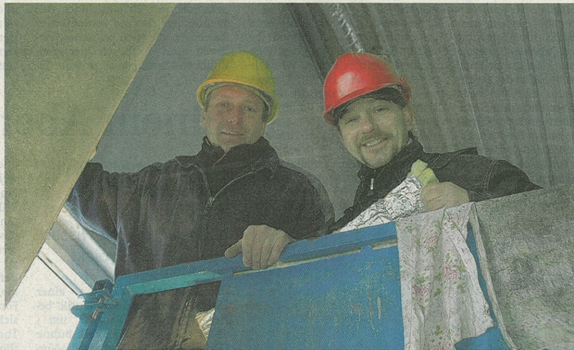
Michael Starke und Kay Thiele (von links) haben gestern an der Dachentwässerung für die neue Lehrwerkstatt bei der Eisengießerei Torgelow gearbeitet. Im Frühsommer soll das Haus fertig sein.
